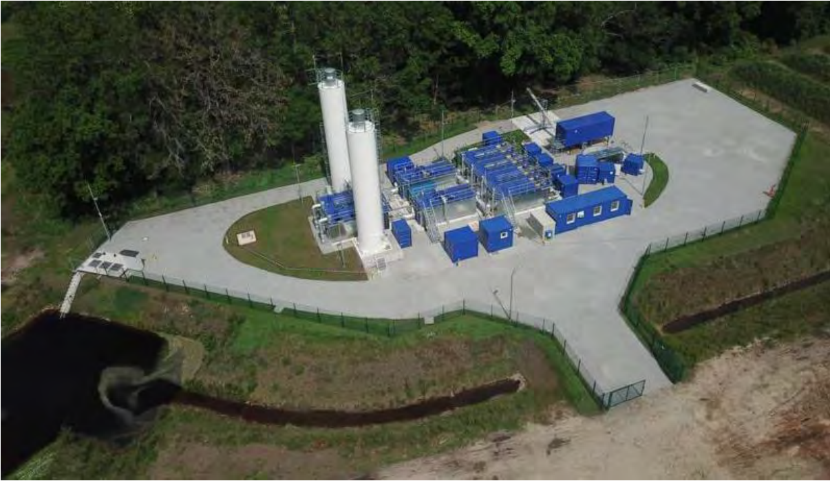
Abbildung 32: Modulare Wasserbehandlungsanlage am Graben Neustadt (Foto: Hartmut Rauhut, 2019).
