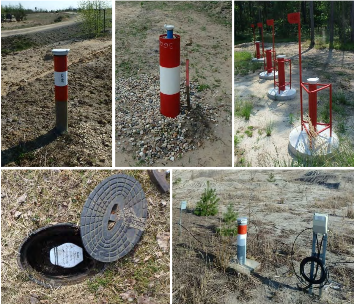
Abbildung 22: Messstellen unterschiedlicher Ausführung und Ausstattung zur Erfassung des Grundwasserstandes, Fotos: Jörn Günther, IWB Possendorf.
