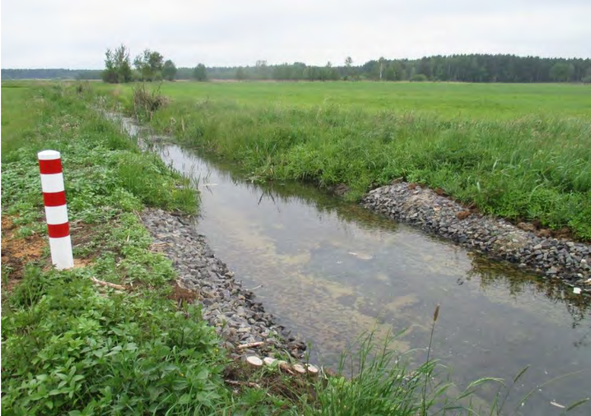
Abbildung 19: Einleitstelle eines Inselbetriebs (Grabkoer Seewiesen), Quelle: LE-B.
