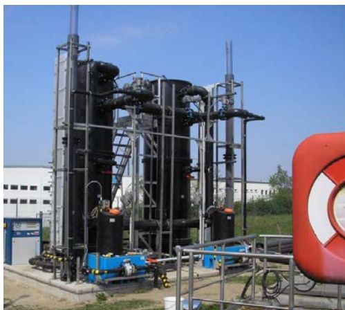
Abbildung B-4: Versuchsanlage auf dem Klärwerk Münchehofe (Quelle: Berliner Wasserbetriebe)
