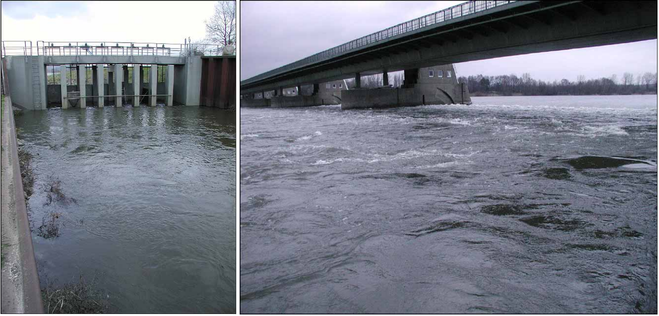
Abb. 2: Fangvorrichtungen (Foto links) und Elbewehr bei Geesthacht (Foto rechts) bei Hochwasser (08.12.07).
