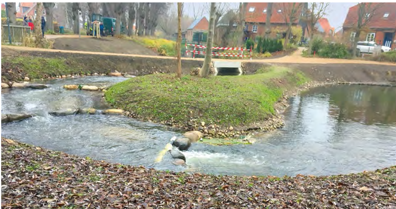
Bauwerk 3 – Durchlass und Beckenpass zwischen Altendorfer Teich und Fitzenteich nach dem Bau
