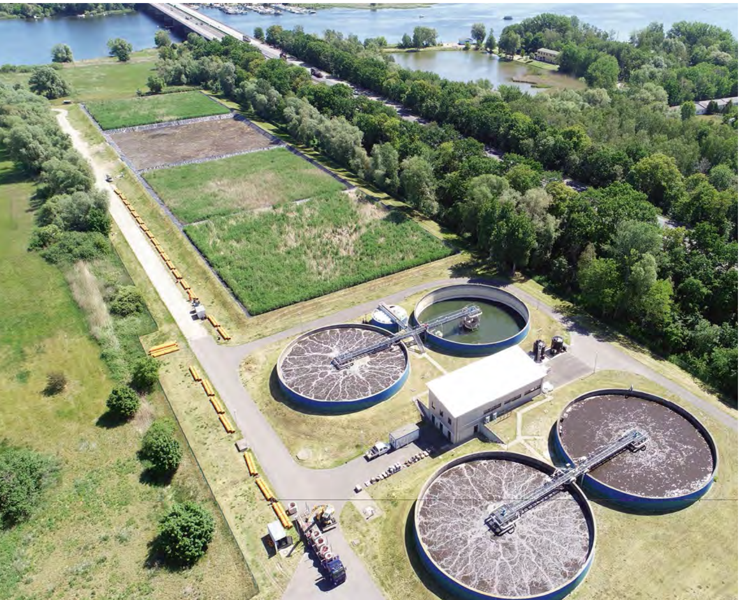
Luftbild der Kläranlage Werder (Havel) mit den vier SBR-Becken und der Einleitstelle in die Havel
