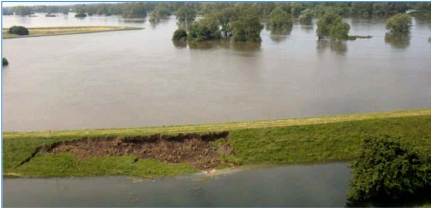
Abb. 3-5: Landseitige Böschungsabrutschung an einem Elbdeich bei Hohengöhren [20]
