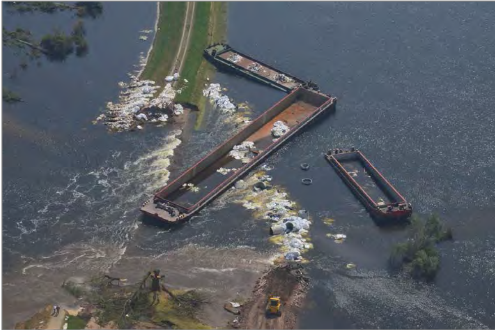
Abbildung 21: Luftaufnahme Deichbruchstelle Fischbeck, 19. Juni 2013 (Quelle: LHW)
