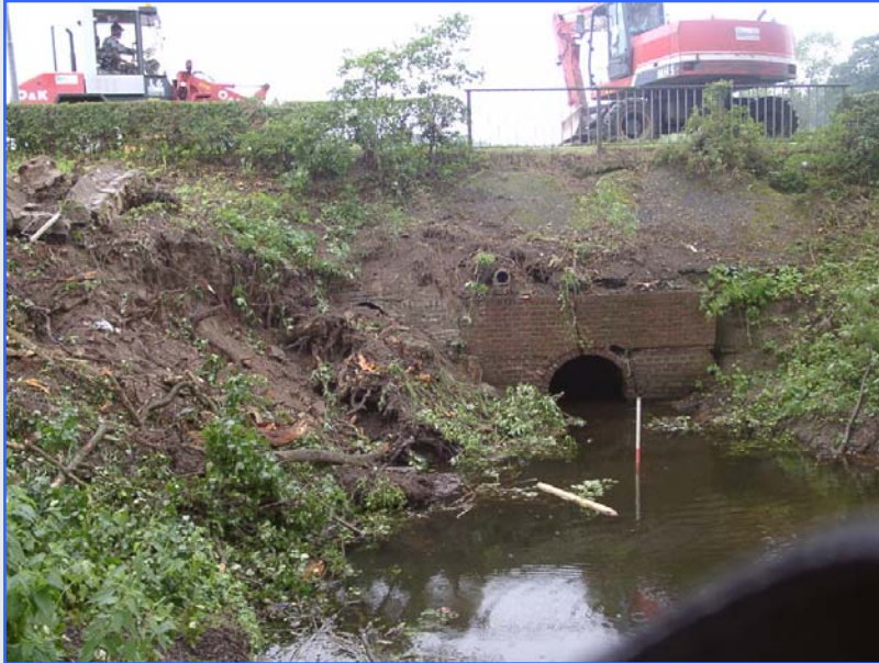
Durchlass im Schlotfelder Graben, nicht durchgängig
